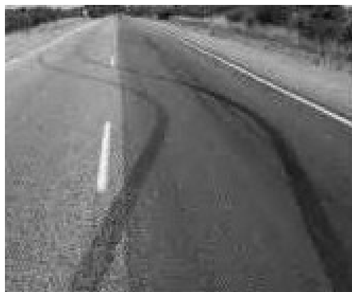
Figura 10- Marcas de derrapagem no piso asfáltico
